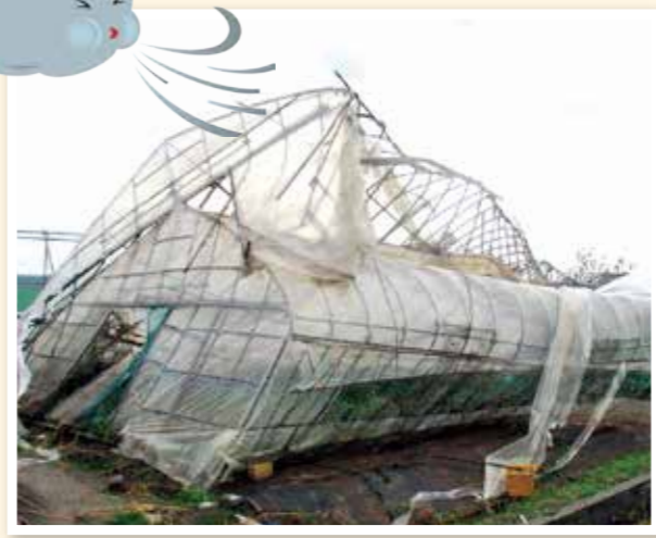
『強風による施設本体の被害』
